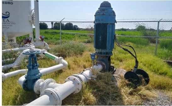
Pozo de agua salobre 4,000 mg/L
