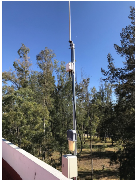
Figura 7. Antena PROCOM CXL900-3LW Fuente: propia
