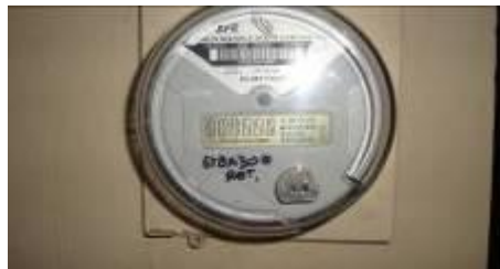
Figura 6. Medidor de energía eléctrica.
