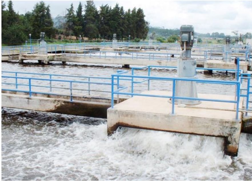
Fig. 1. Planta de tratamiento de Lodos activados localizada en Quetchehueca al sur de Cd. Obregon, Sonora.
